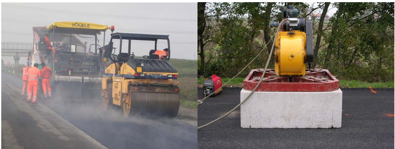
Figura 4. Esecuzione della pavimentazione sperimentale anti-vibrante e realizzazione delle prove dinamiche in situ
